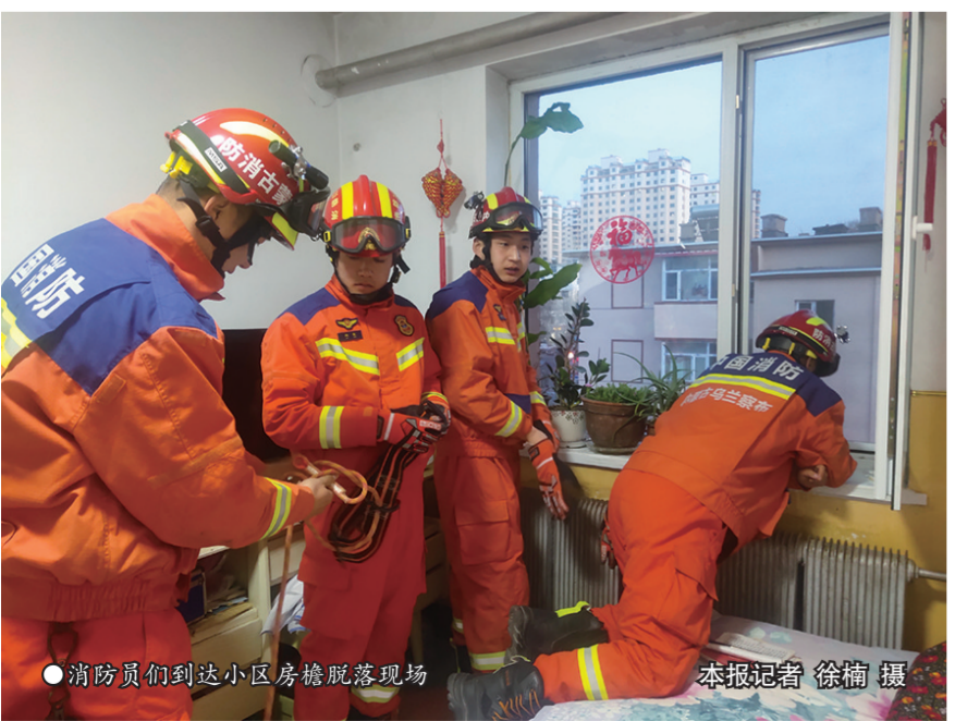
●消防员们到达小区房檐脱落现场 本报记者 徐楠 摄
