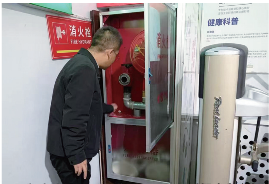
工作人员检查消防设施 本报记者 朱旭敏 摄
